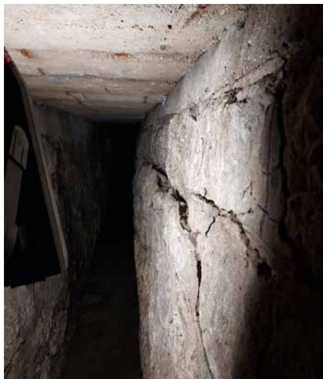
L'immagine delle rotture sul fianco delle murature della Roggia verso la SP 84, a rischio di crollo
